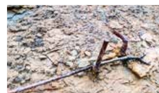
酸性硫酸塩土壌は、写真のように灰色や白色の泥岩質であることが多く、金属の腐食を引き起こす場合もある。
